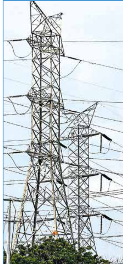
Interconexión eléctrica 2019. / Foto: Archivo El Tiempo.
