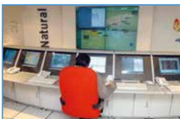
Centro de Control de Gas Natural. / Foto: Archivo El Tiempo.
