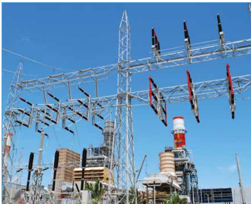
Estación eléctrica. / Foto: Archivo El Tiempo.
