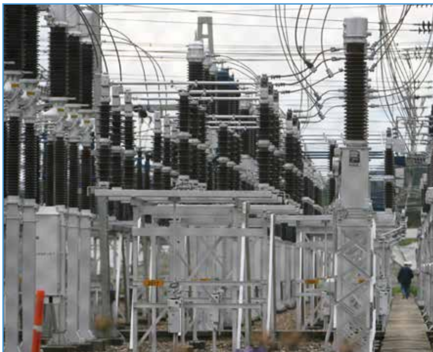
Subestación eléctrica. / Foto: Archivo El Tiempo.
