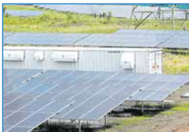
Planta de energía solar de Celsia en Yumbo. / Foto: Archivo El Tiempo.
